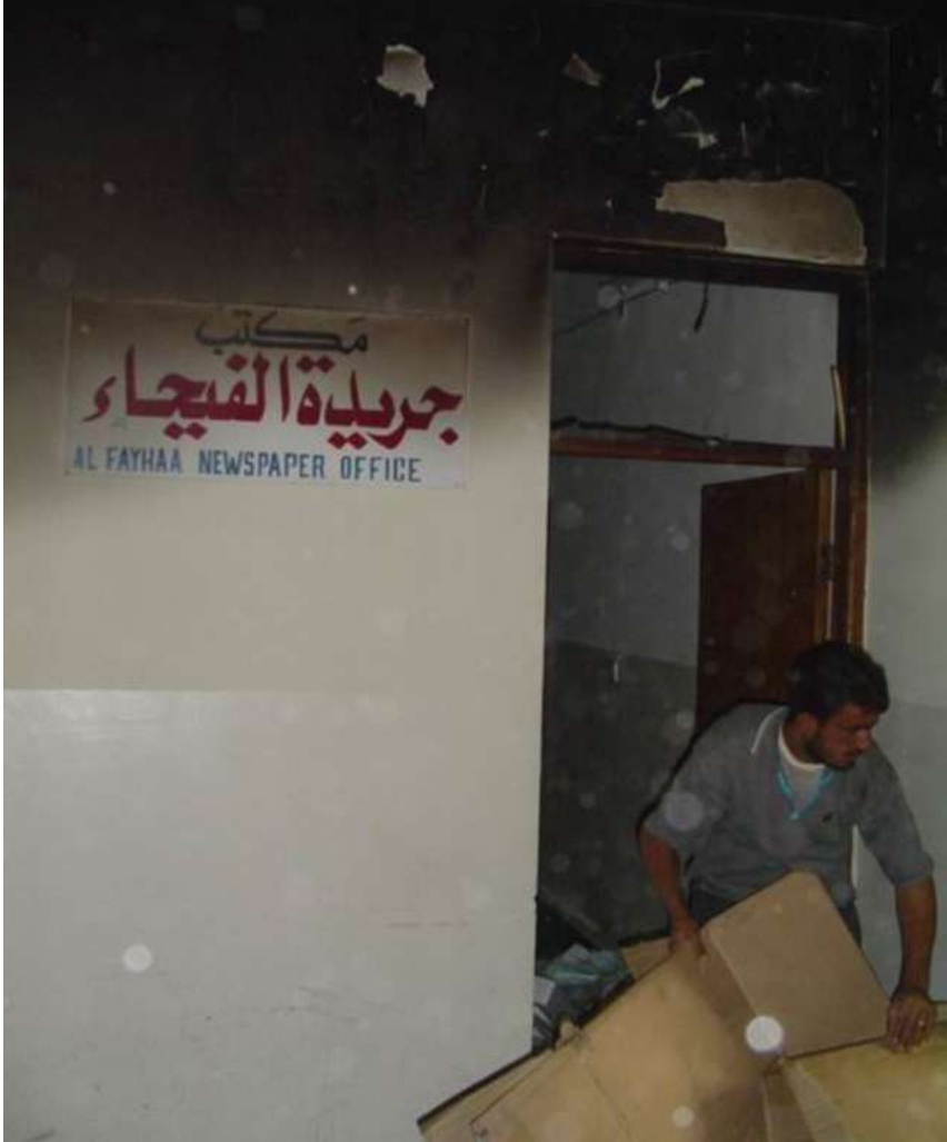
صورة رقم (٤٩) الأضرار التي طالت المبنى
