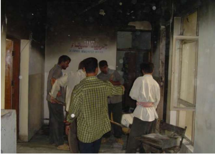
صورة رقم (٥٠) لجدران المبنى تجسد مدى الضرر
