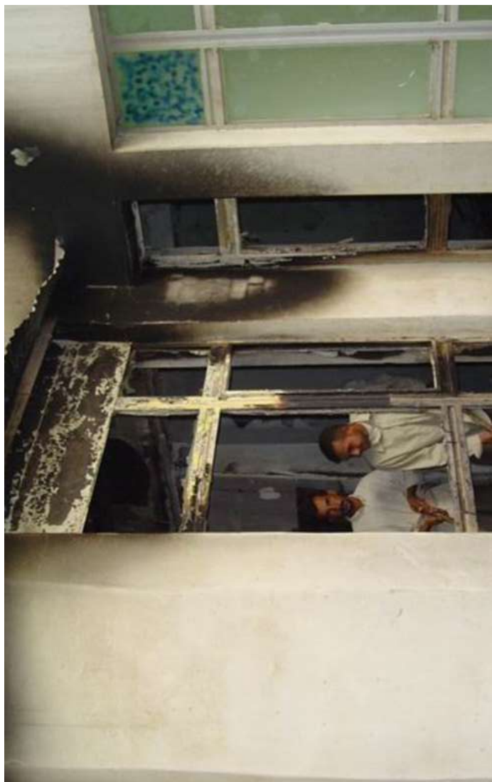
صورة رقم (٤٨) تمثل حجم الضرر في المبنى
