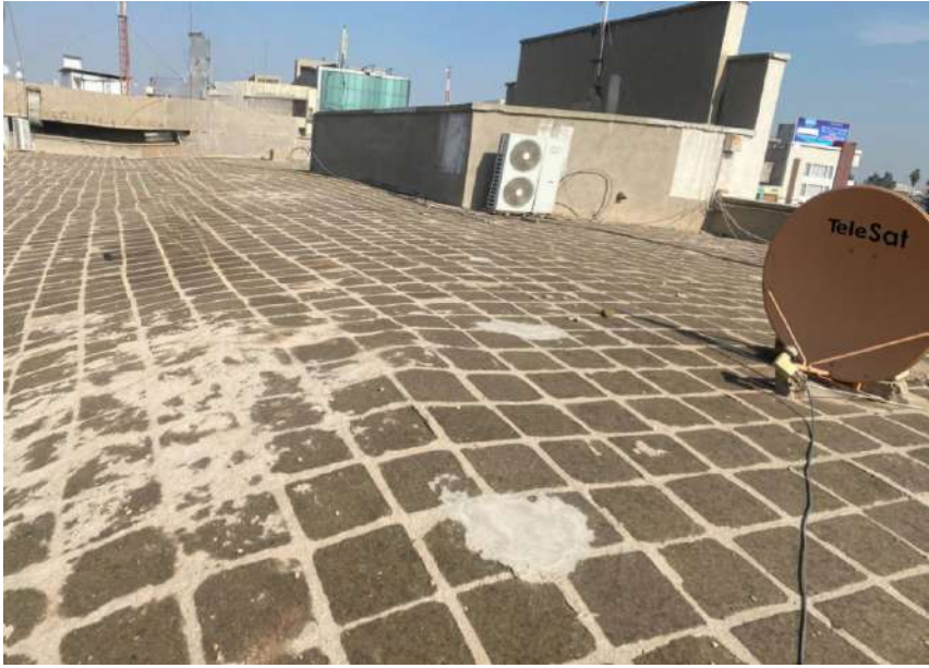
صورة رقم (٢٨) لسطح المبنى ويظهر التحذب نحو الجهة الجنوبية والغرض منه نزول الماء باتجاه الميازيب للحيلولة دون تجمعها على سطح المبنى
